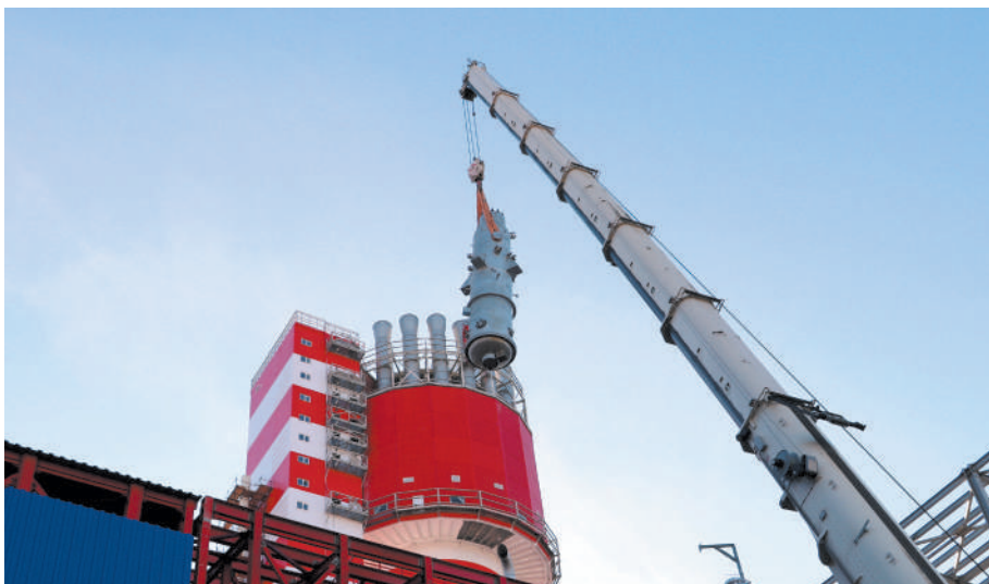
Монтажники компании «Энергострой» успешно подняли и завершили установку на штатное место 26-тонного скруббера высокого давления на насосной станции цеха меламина.
