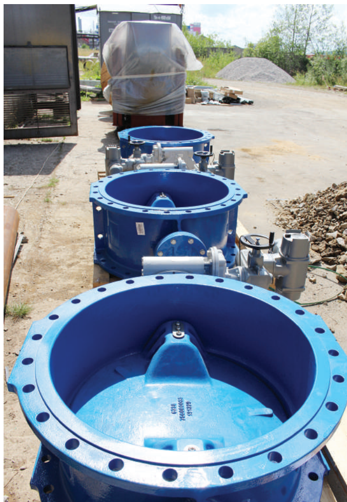
На объекте 1-го этапа технического перевооружения насосной станции 4-го подъема готовая к монтажу запорная арматура
