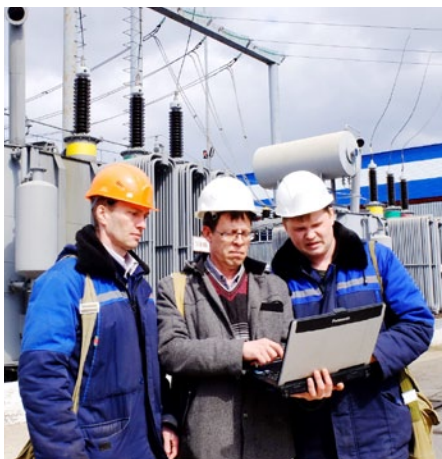
Сотрудники цеха электроснабжения Станислав ЧЕРНИКОВ, Игорь ПИЧКАЛЕВ и Юрий БАЙЕР проводят профилактический осмотр состояния силового оборудования
