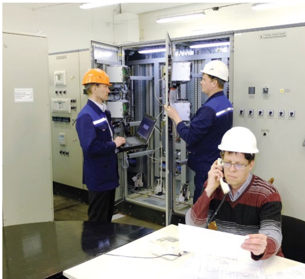
Электромонтёр Станислав ЧЕРНИКОВ, начальник участка по обслуживанию релейной защиты и автоматики Юрий БАЙЕР и начальник электротехнической лаборатории ЦЭС Игорь ПИЧКАЛЁВ проводят профилактический контроль состояния релейной защиты на главной понизительной подстанции ПАО «Метафракс»
