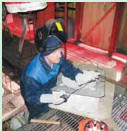
Сварщик ООО «Теплострой» Олег РУБЦОВ. Проводится замена теплоизоляции и готовится место для замены горелок 2-й печи риформинга.
