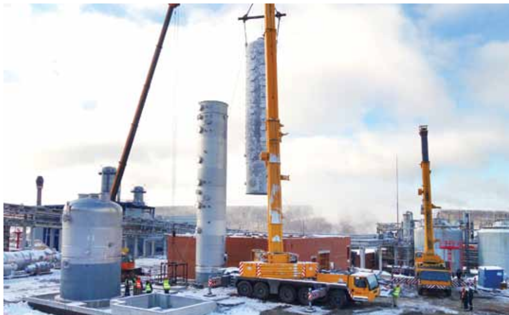
Силами компании «Мегастрой» на будущей производственной площадке по выпуску 55-процентного формалина ведутся строительные-монтажные работы под контролем фирмы «Johnson Matthey Formox».
