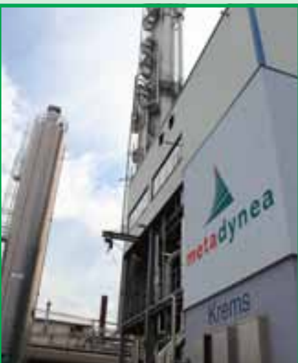
Установка формальдегида № 3 в Кремсе, на основе технологии на серебряном катализаторе. Установка была построена в 2008/2009 гг. и находится в эксплуатации с июля 2009 г.
